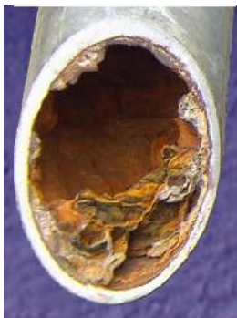
Abb.2: stark korrodiertes Rohr im Querschnitt.
